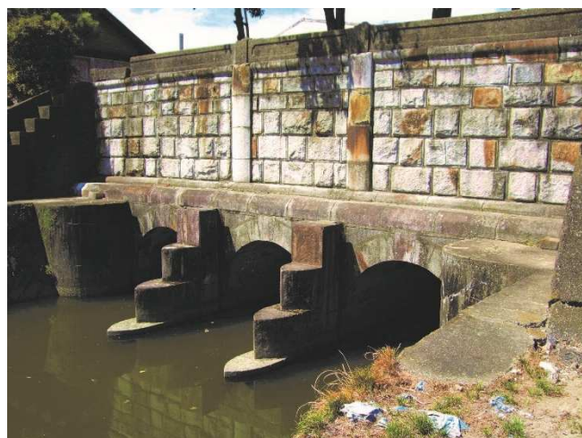
12. 郡築二番町樋門(斜めより撮影)
